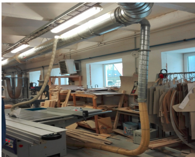
Joonis 19. Osadel seadmetel puuduvad sulgesiibrid.
