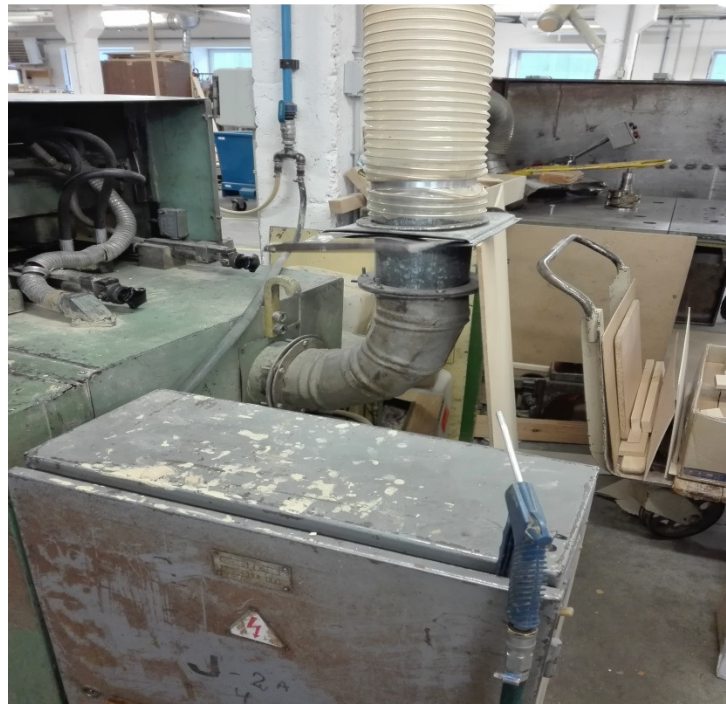
Joonis 15 Suletud, kuid mittetihe sulgesiiber põhjustab õhuleket.
