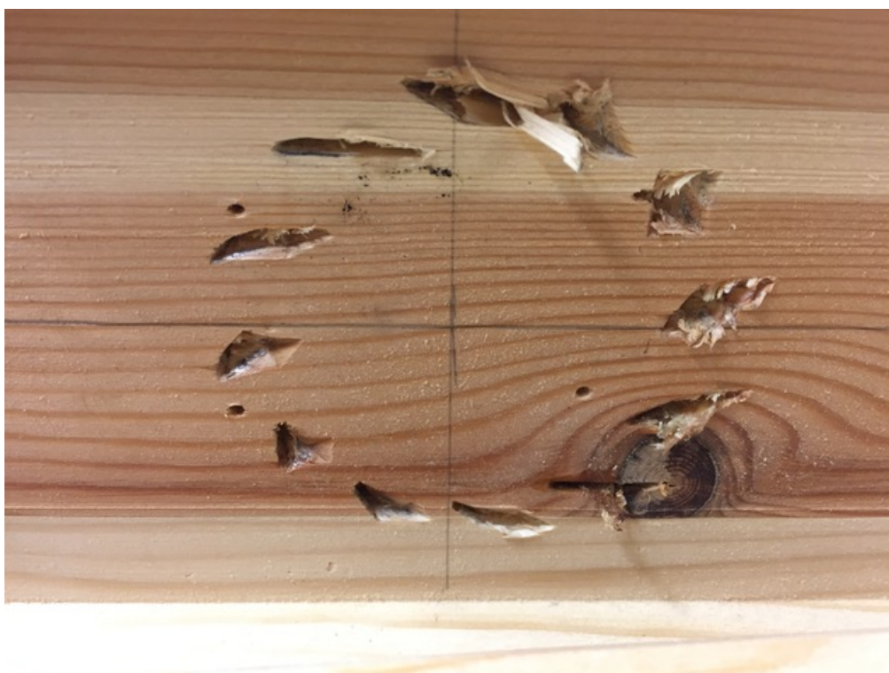
Joonis L5.8. Katsekehale KK24-C1/75 tekkinud hammastüübli jäljend
