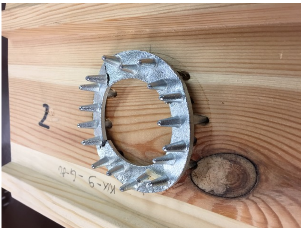
Joonis L3.17. Katsekeha KK9-C10/80 hammastüübli purunemine
