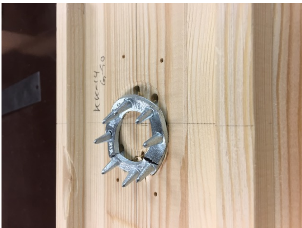
Joonis L4.7. Katsekeha KK14-C10/50 hammastüübli purunemine
