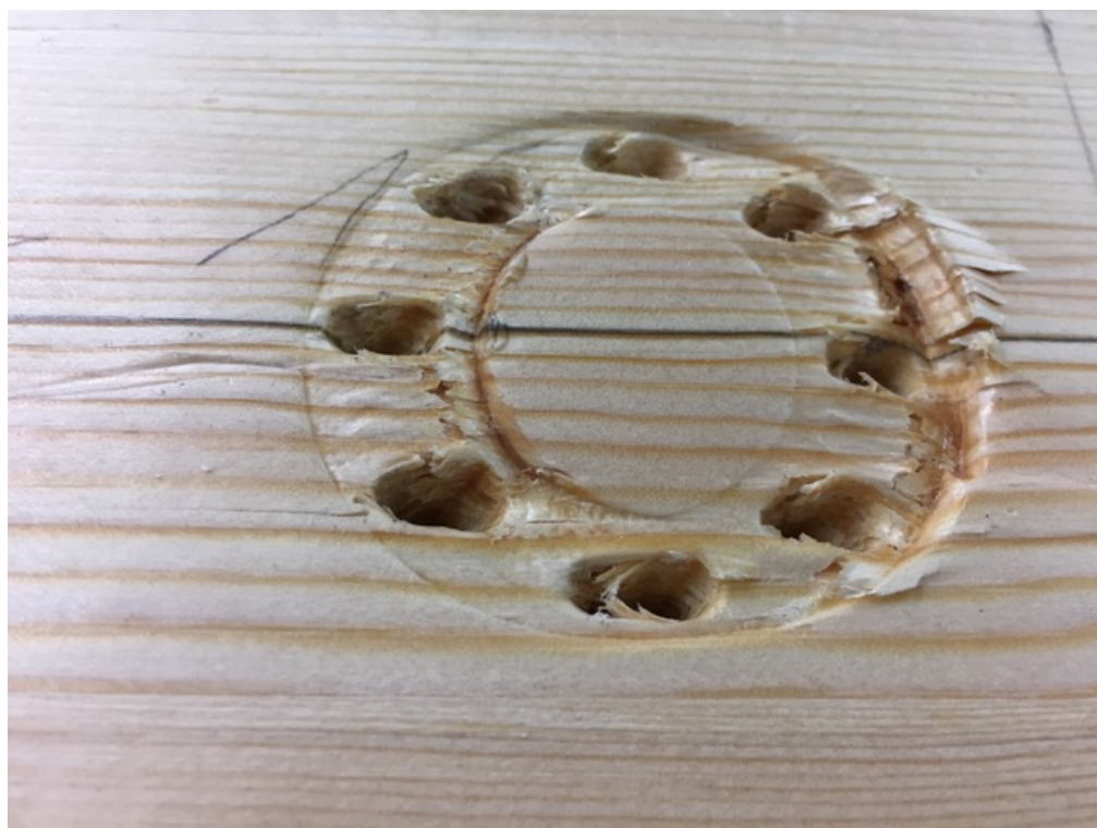
Joonis L6.2. Katsekehale KK31-2xC10/50 tekkinud hammastüübli muljumise jäljend
