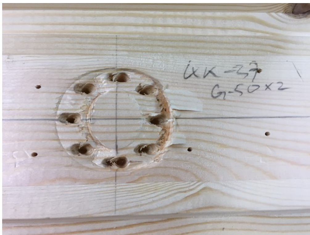
Joonis L6.14. Katsekehale KK37-2xC10/50 tekkinud hammastüübli muljumise jäljend
