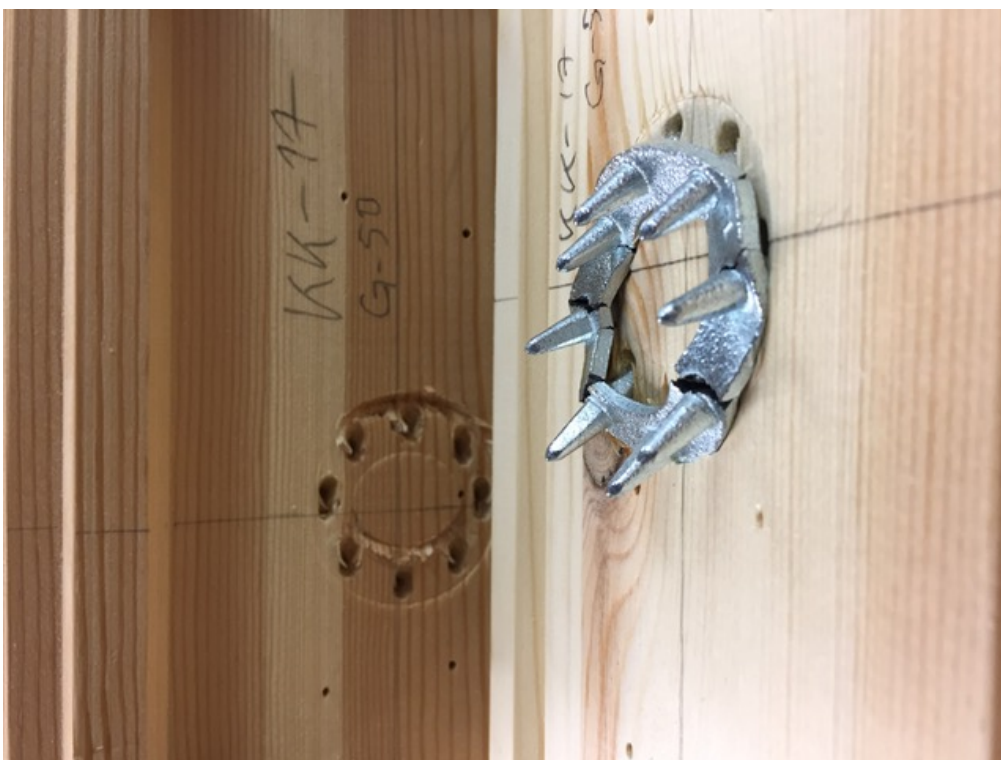
Joonis L4.13. Katsekeha KK17-C10/50 hammastüübli purunemine
