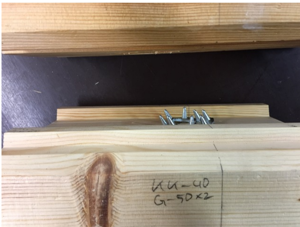
Joonis L6.19. Katsekeha KK40-2xC10/50 hammastüübli purunemine
