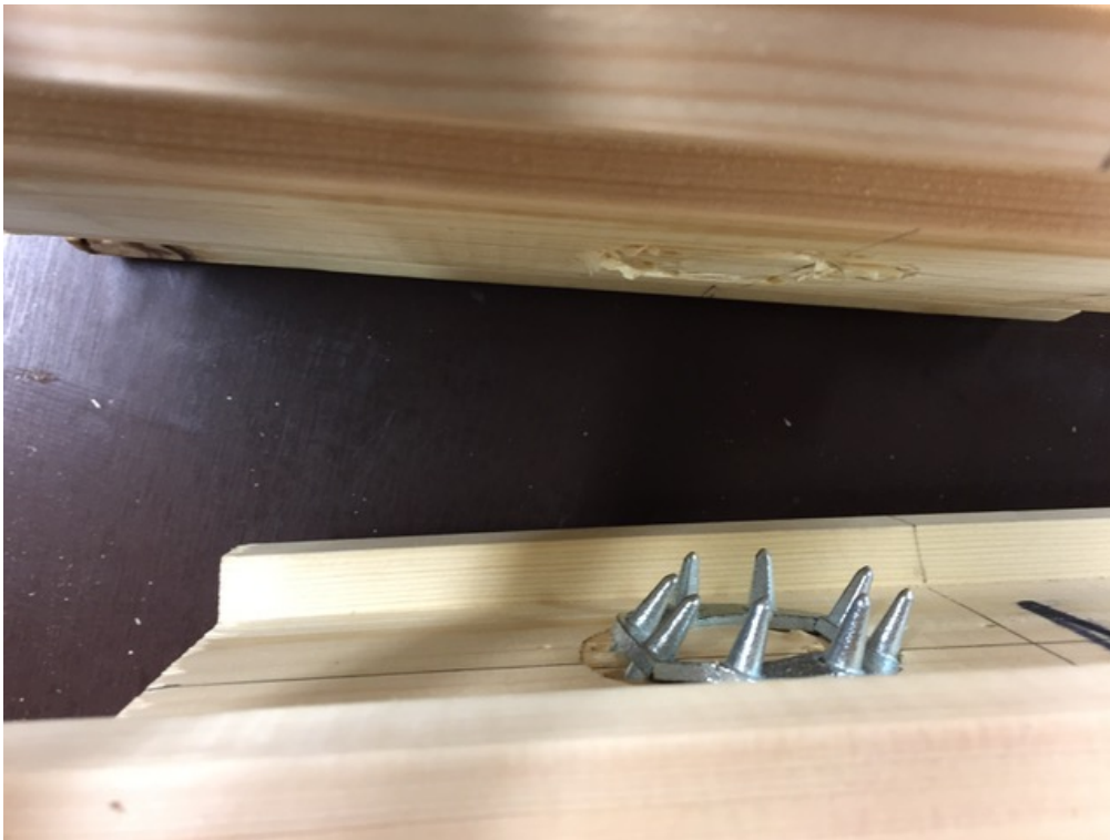
Joonis L6.11. Katsekeha KK36-2xC10/50 hammastüübli purunemine
