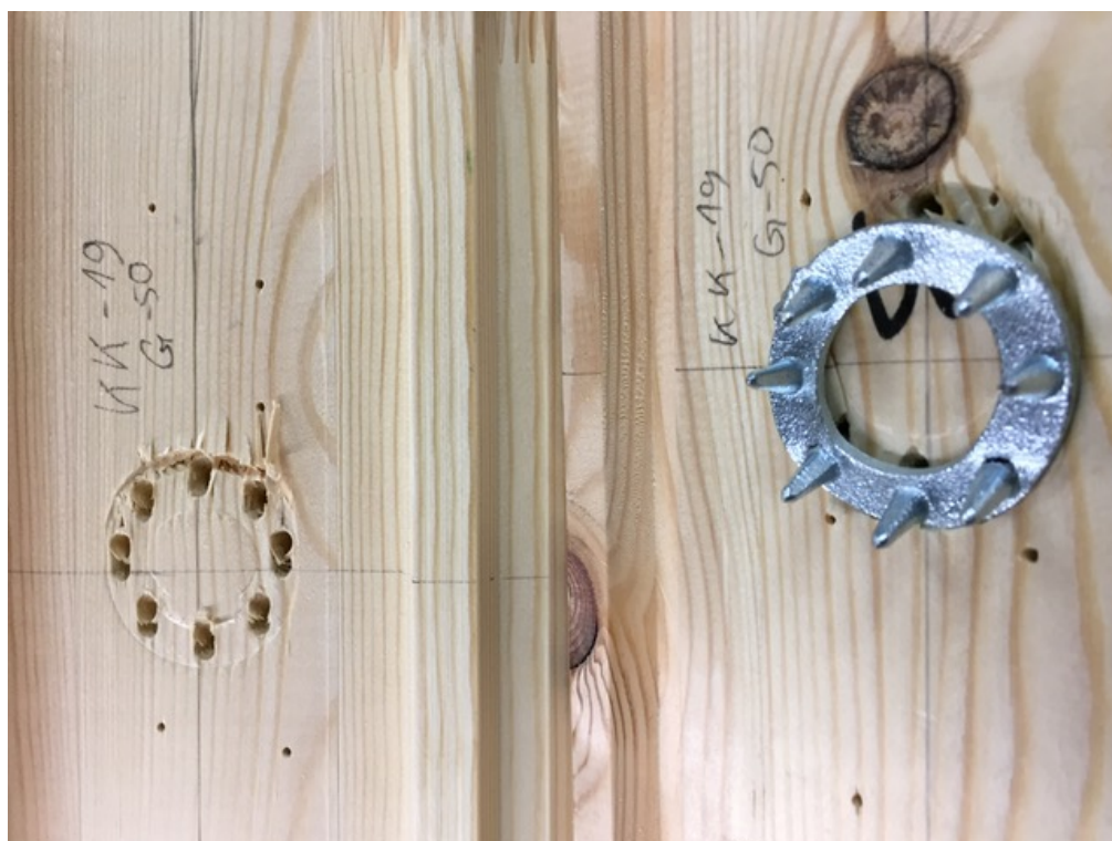
Joonis L4.18. Katsekehale KK19-C10/50 tekkinud hammastüübli jäljend
