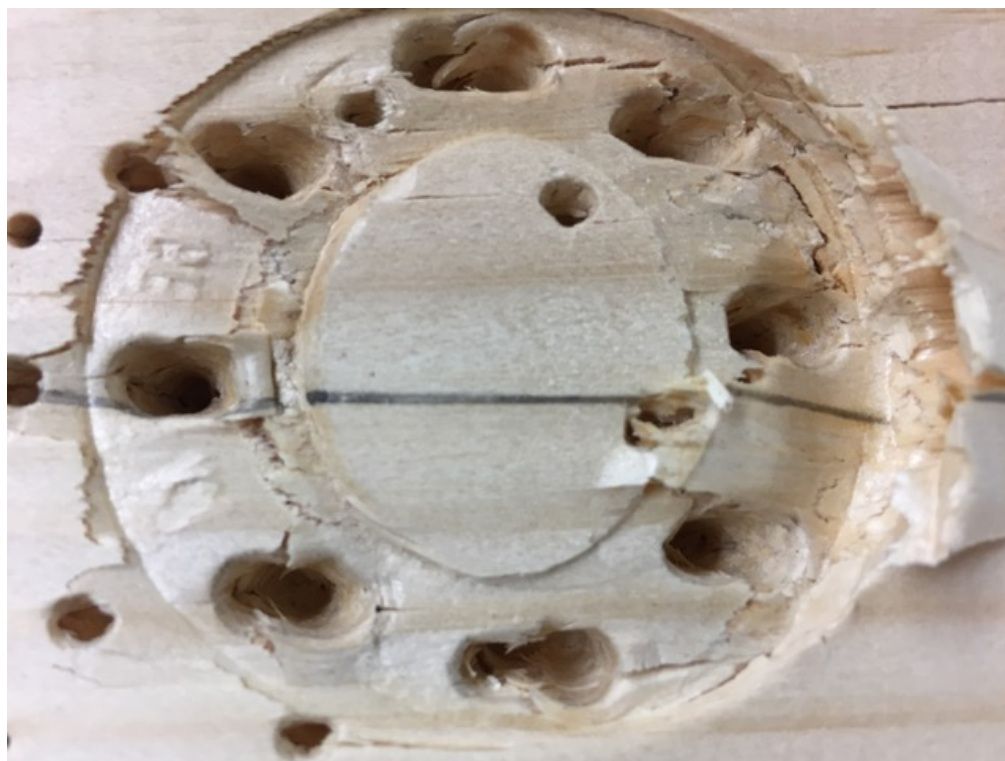
Joonis L6.18. Katsekehale KK39-2xC10/50 tekkinud hammastüübli muljumise jäljend
