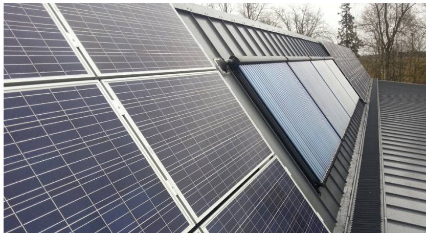
Joonis 2.7 Päikesepaneelid katusel. Vaade lõunast (ülemine pilt), vaade läänest (alumine pilt) Allikas: smartecon.ee
