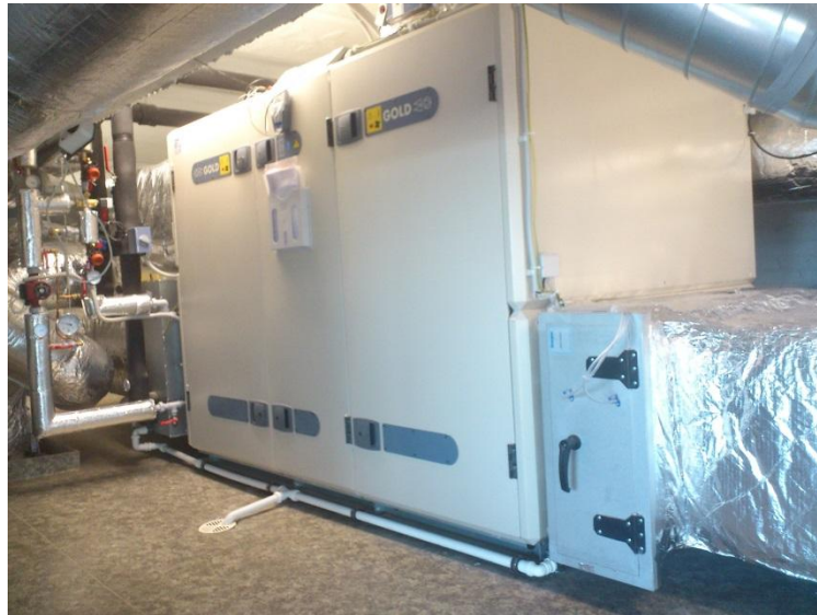
Joonis 2.5. Ventilatsiooniseade SWEGON GOLD 25 D RX Eesti Maaülikooli Tehnikamajas
