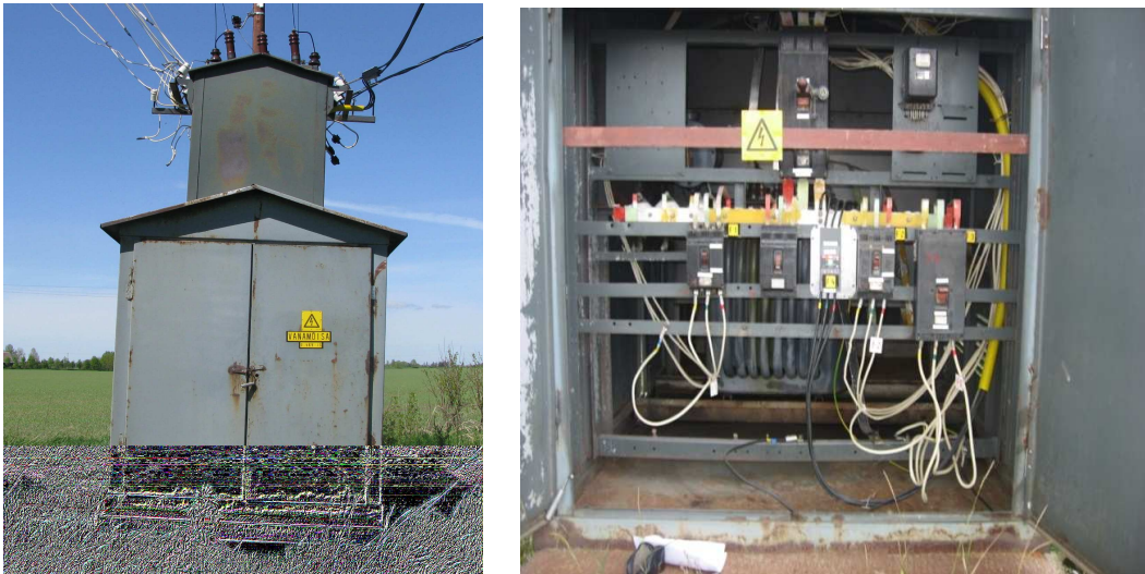
Joonis 2.1. Vanamõisa 10/0,4 kV alajaam Vanamõisa külas Torma vallas [2]
