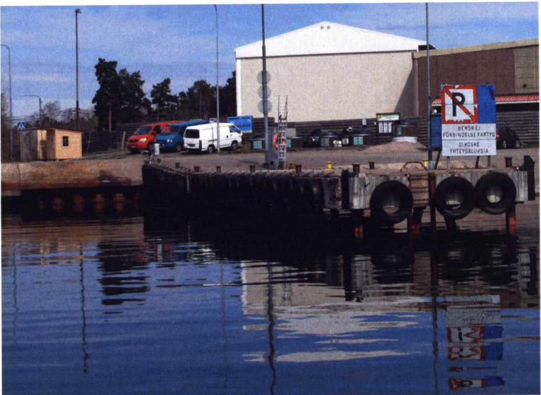
Kuva 7. Keulaporttipaikka vasemmalla on rakennettu teräsponttiseinän varaan, laiturin tukirakenteena ovat teräsputkipaalut (Kasnäsin maantielaituri, Kemiönsaari).
