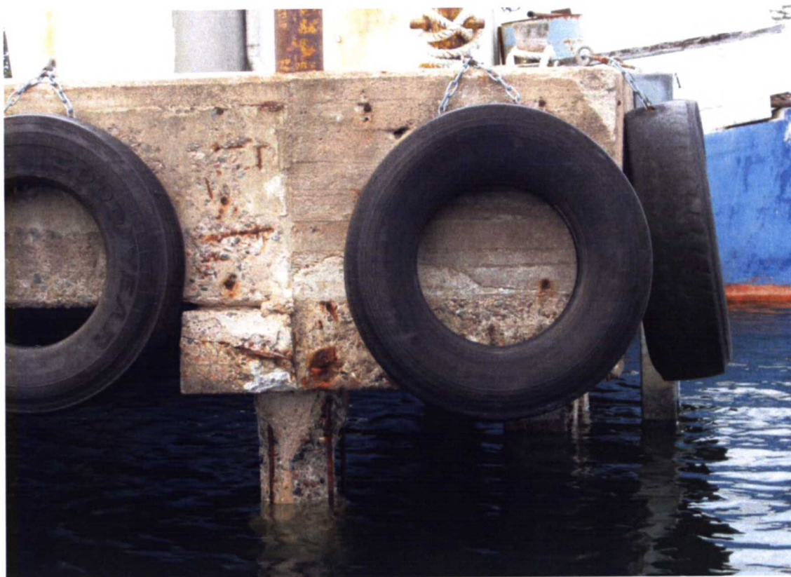
Kuva 17. Hiittisten maantielaituri 2013. Useimmat laiturin teräsbetonipaaluista ovat jo pahoin kuluneet ja muodostavat merkittävän turvallisuusriskin.
