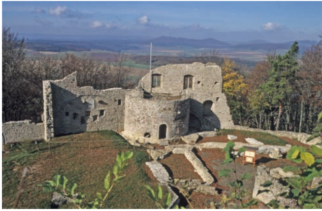
Abb. 33 Blick auf die Mauer nach der Sanierung 1995, Ansicht von Osten (Aufnahme Frühjahr 1996)
