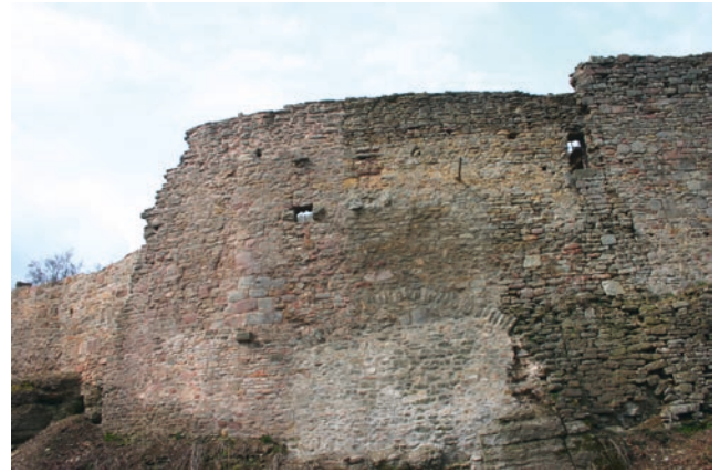
Abb. 142 Burgruine Henneberg, Ringmauer, Abschnitt öR-5, drei zugesezte Aborterker von Osten (Aufnahme 2004)
