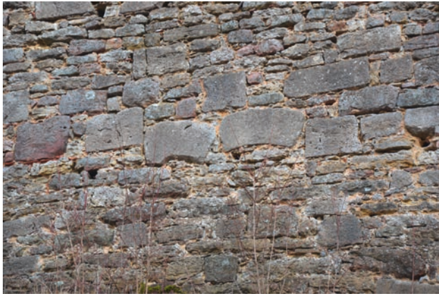
Abb. 145 Burgruine Henneberg, Ringmauer, Abschnitt wR-3, sekundär verbaute Gewändefragmente von Westen (Aufnahme 2013)
