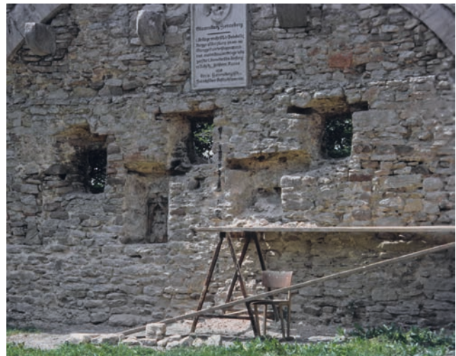
Abb. 102 In der unteren Reihe in der Mauer ist noch der freigelegte Holzrahmen als Originalbefund zu sehen (Aufnahme 1992)
