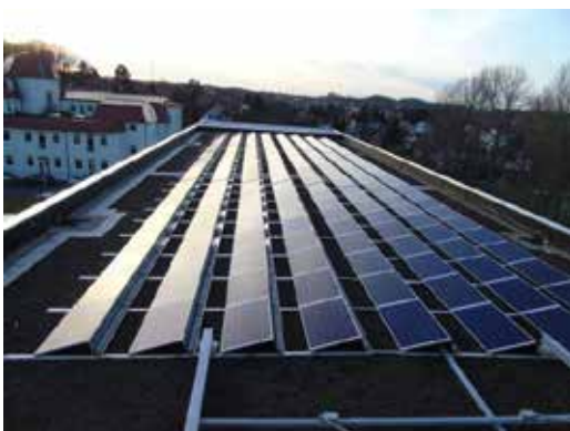
Abbildung 3: PV-Anlage auf Technikum II
