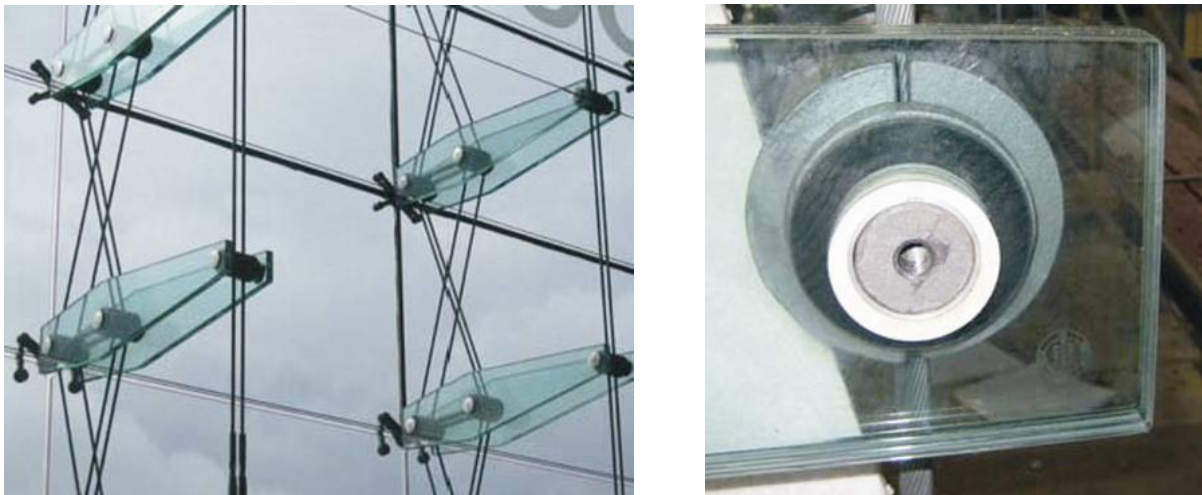
Bild 1.2: Eingangsfassade Hauptbahnhof Berlin, Scher-Lochleibungsverbindungen der Glasschwerter, die zur Aussteifung der Fassade herangezogen werden
