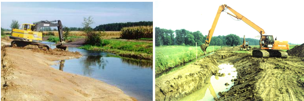
Abbildung B.28: Herstellen einer Sekundäraue durch Abgrabungen im Vorland (LfU BW, 2002a)
