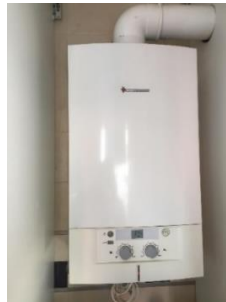
Figura 4.3 - Caldeira utilizada para aquecimento ambiente
