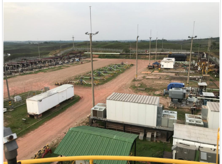
Grafico 1: PAD de inyección de agua industrial
