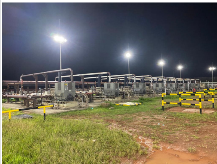
Grafico 2: Sección de bombeo de agua industrial para inyección
