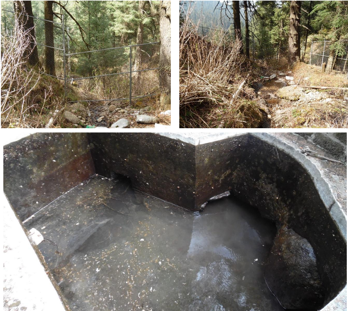
Figura 4.4. Manantial La Cocinera, Isidro Fabela, Estado de México.
