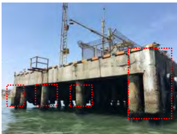
Figura 36. Daños en el soporte del muelle Elaboración propia
