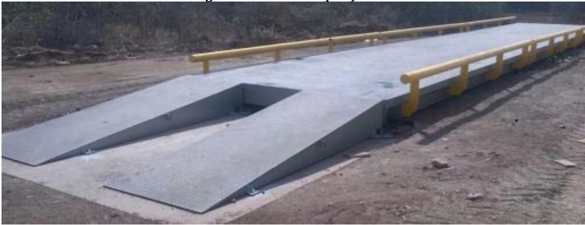
Fotografía 18. Sistema de pesaje de RCD
