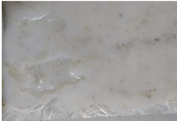
Ilustración 14– Imperfecciones superficiales en la matriz. Fuente: Los autores .
