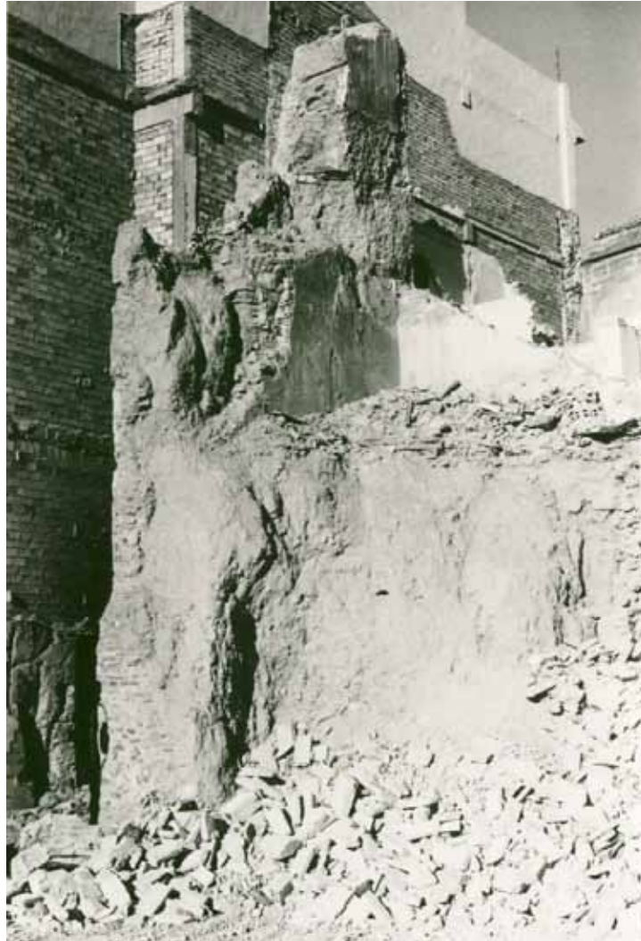
Fig. 103. Murcia. Torreón de la muralla del alcázar aparecido durante la demolición de la casa del obispo Trejo, entre las calles Apóstoles y Eulogio Soriano (Navarro Palazón y Jiménez Castillo, 1991-1992)
