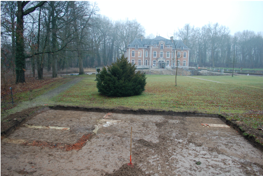
Figuur 8: Overzichtsfoto van de werkput vanuit het noordwesten (@agentschap Onroerend Erfgoed: Geert Vynckier).
