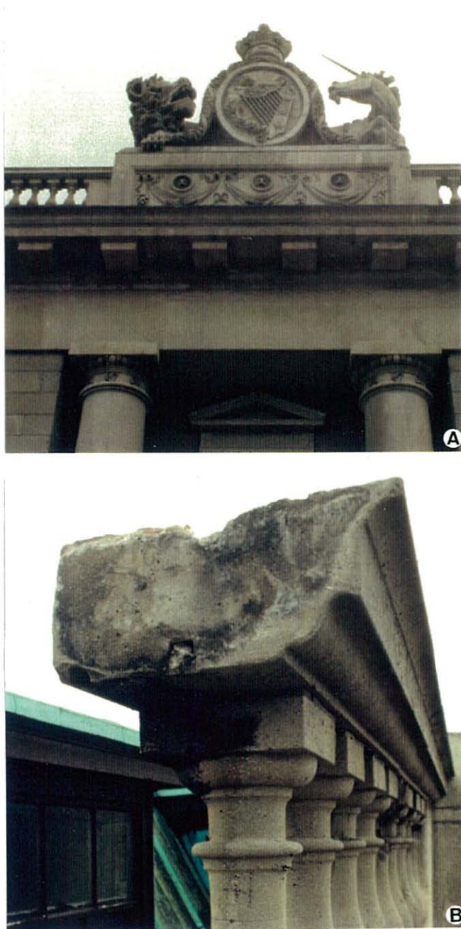
Figura 1.- a : Vista general de la balastrada superior del edificio Custom House (Dublín). b : Detalle de la balastrada donde puede observarse la costra negra formada.
