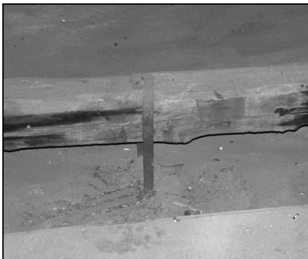
Figura 7. Brida de viga de sujeción del plafón.
