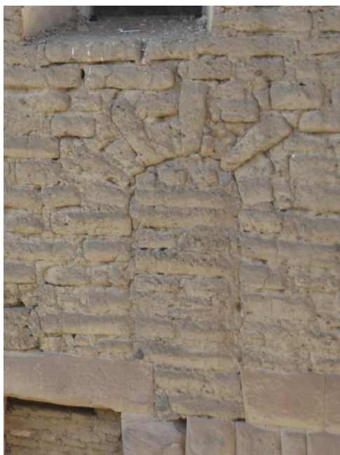
Fig. 46. Vista de entrada clausurada en la pared Norte de la iglesia San Juan Bautista.
