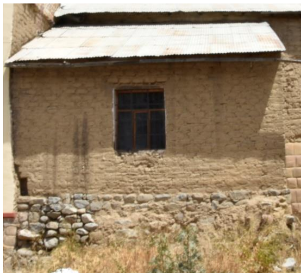
Fig. 62. Mampostería de piedra desordenada, en el lado exterior de lado Norte de la Iglesia San Juan Bautista
