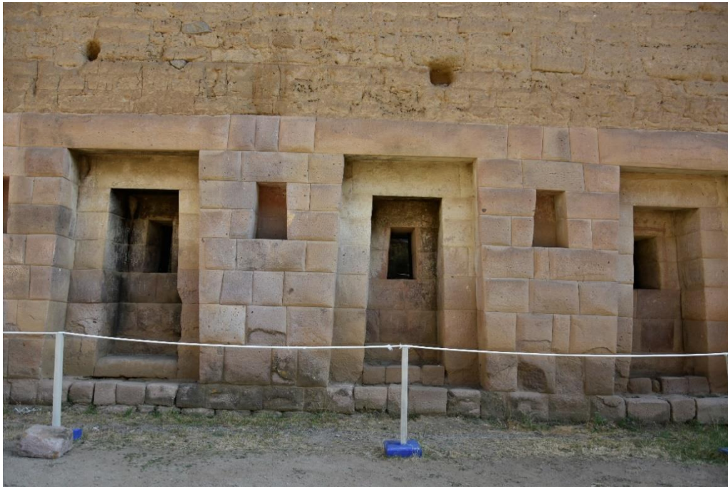
Fig. 78. Rocas descolocadas en la primera fila del muro tipo Inca por acción del Agua
