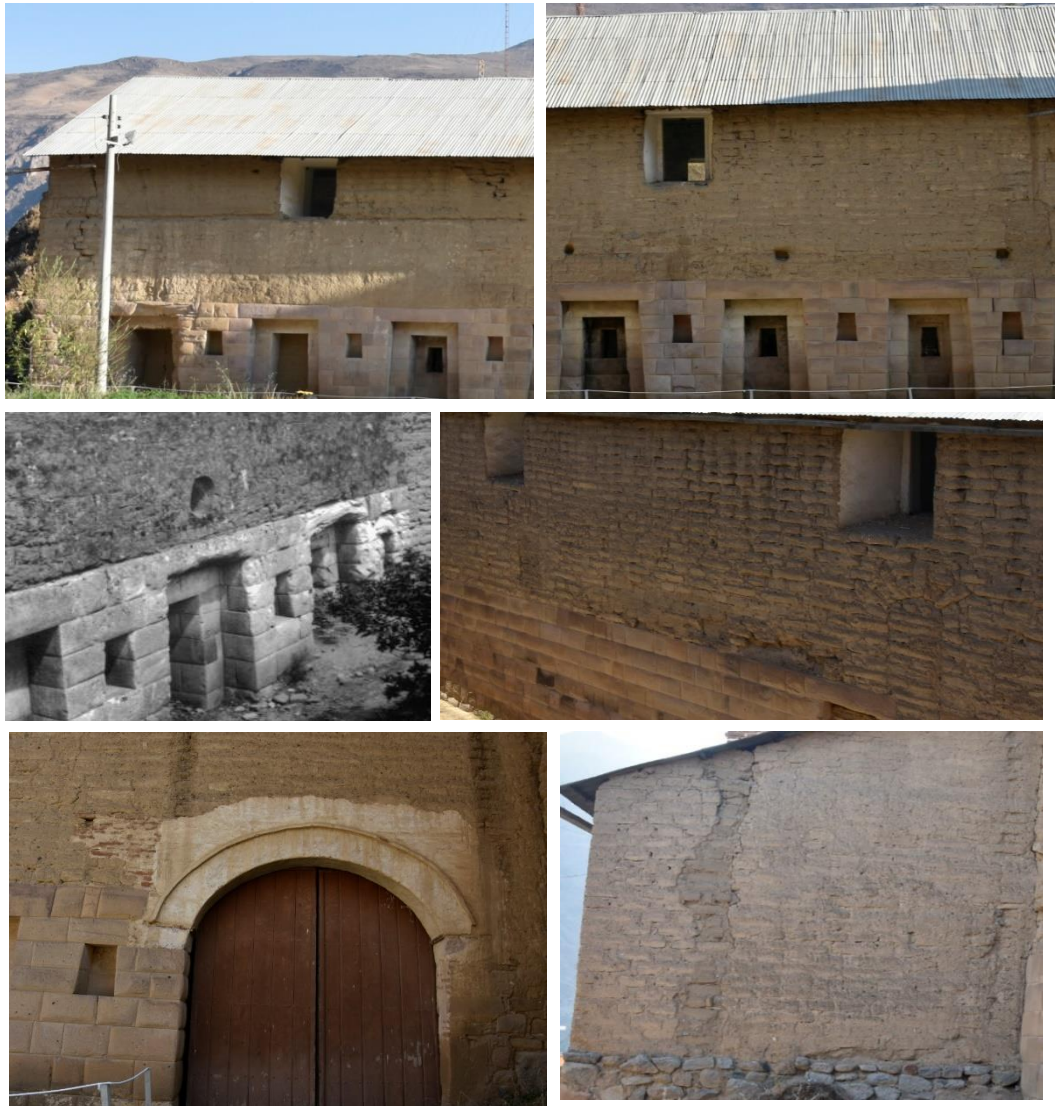
Fig. 76. Alteraciones que se han realizado en la mampostería de la nave de la iglesia, a) excavación horizontal sobre le muro de adobe, b) y c) excavación circular sobre el muro Sur de adobe y la fachada posterior (oeste), d) clausura de las entradas tipo arco e el muro de adobe Norte e) Reparacion de la seccion superior de la entrada lateral a la nave con mamaposteria de ladrillo y cal, f) reparacion en el muro oeste de la sacristia.
