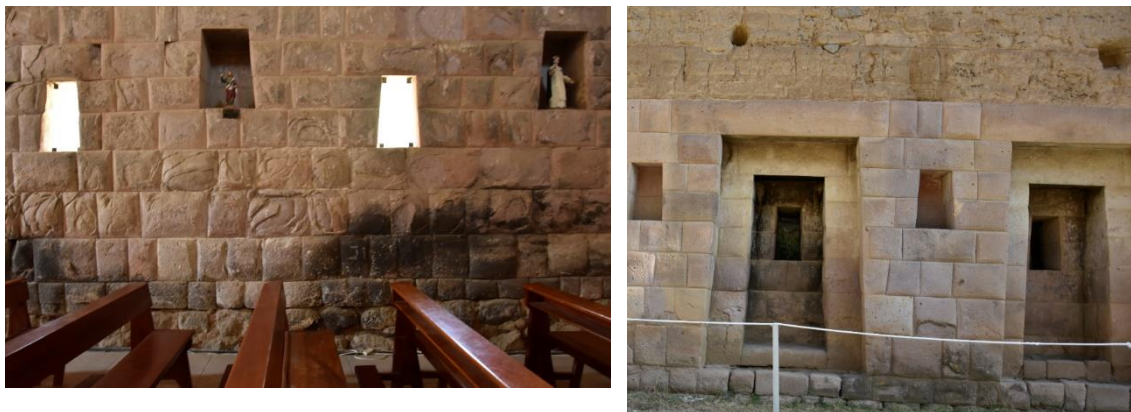
Fig. 81. Huellas de los incendios en el muro interior Sur de la nave (izquierda) y huellas del incendio de las jambas en el muro exterior Sur.
