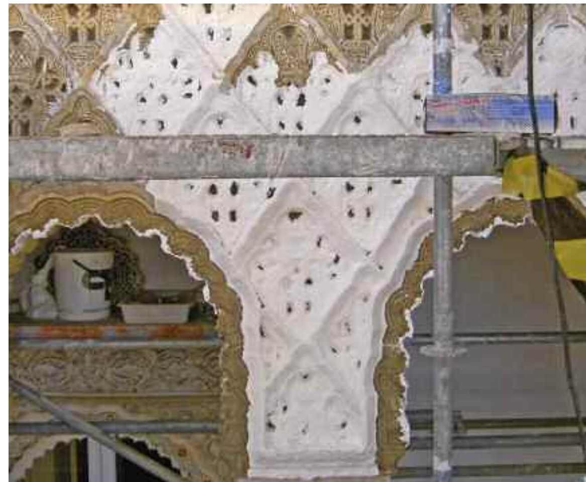
De arriba a abajo. Fig. 25. Limpieza de las yeserías mediante papetas de celulosa
