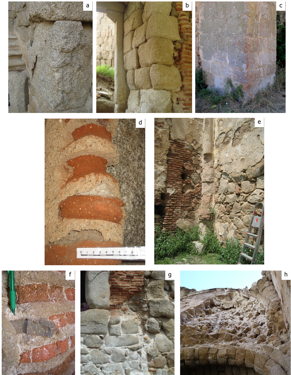
Fig. 3. Deterioro observado in situ en los materiales de construcción.
