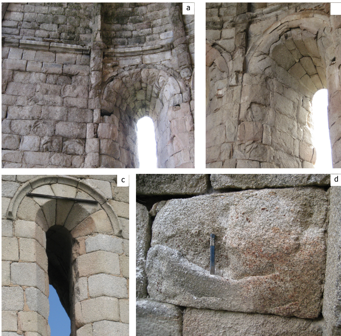
Fig. 4. Deterioro de la sillería granítica en la cabecera de la iglesia por acción del fuego.
