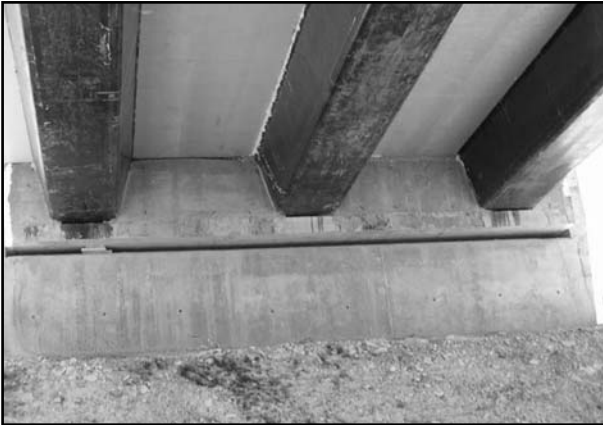
Figura 6. Detalle de las vigas longitudinales del paso superior de la Autovía del Cantábrico en carbono/epoxi y espuma de poliuretano.
