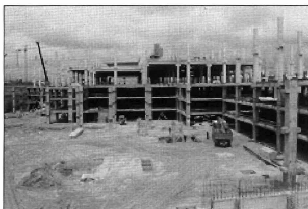
Figura 4.- Estructura prefabricada con pórticos de nudos rígidos (solución nudo macizo). Apropia para zonas sísmicas.
