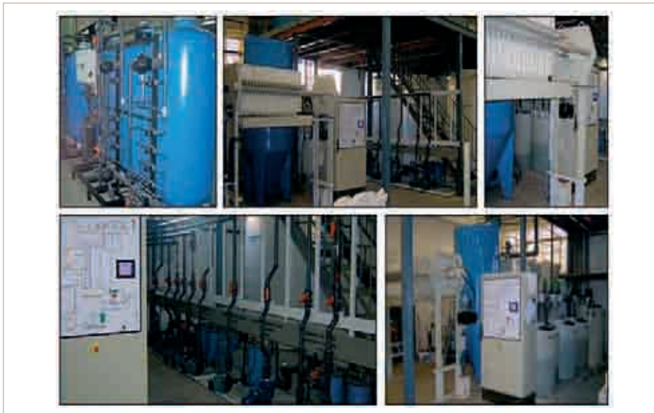
Figura 12.4.3. Instalación de intercambio iónico
