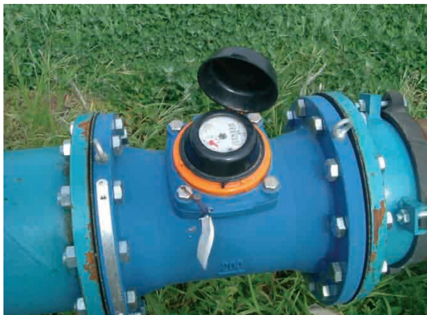
Caudalímetro que habría que colocar en cada extracción.
