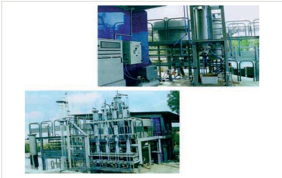
Figura 12.4.2. Instalación de tratamiento con carbón activo
