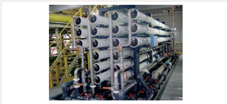
Figura 12.3.4. Instalación de ósmosis inversa
