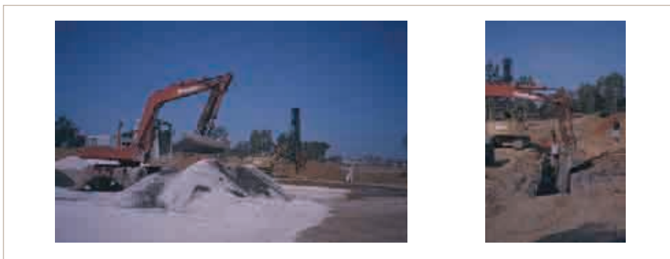
Figura 6.4.3. Construcción de una barrera reactiva para tratar el agua ácida del acuífero del río Agrio, Aznalcollar, Sevilla. Se trata de la excavación de una zanja y su relleno por una mezcla de grava de caliza y materia vegetal. Se espera que al atravesar la barrera el agua aumente el pH y disminuya el pe precipitando hidroxisulfatos de Fe y Al y sulfuros de metales
