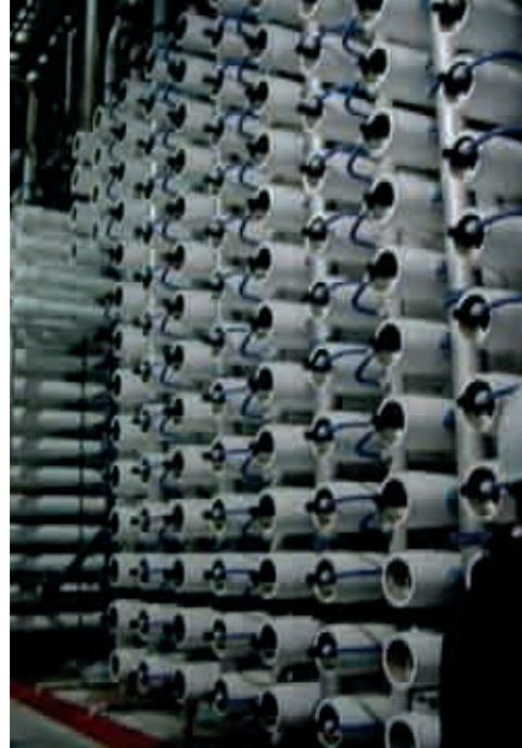
Interior de una planta desaladora. Conjuntos de membranas de ósmosis inversa.
