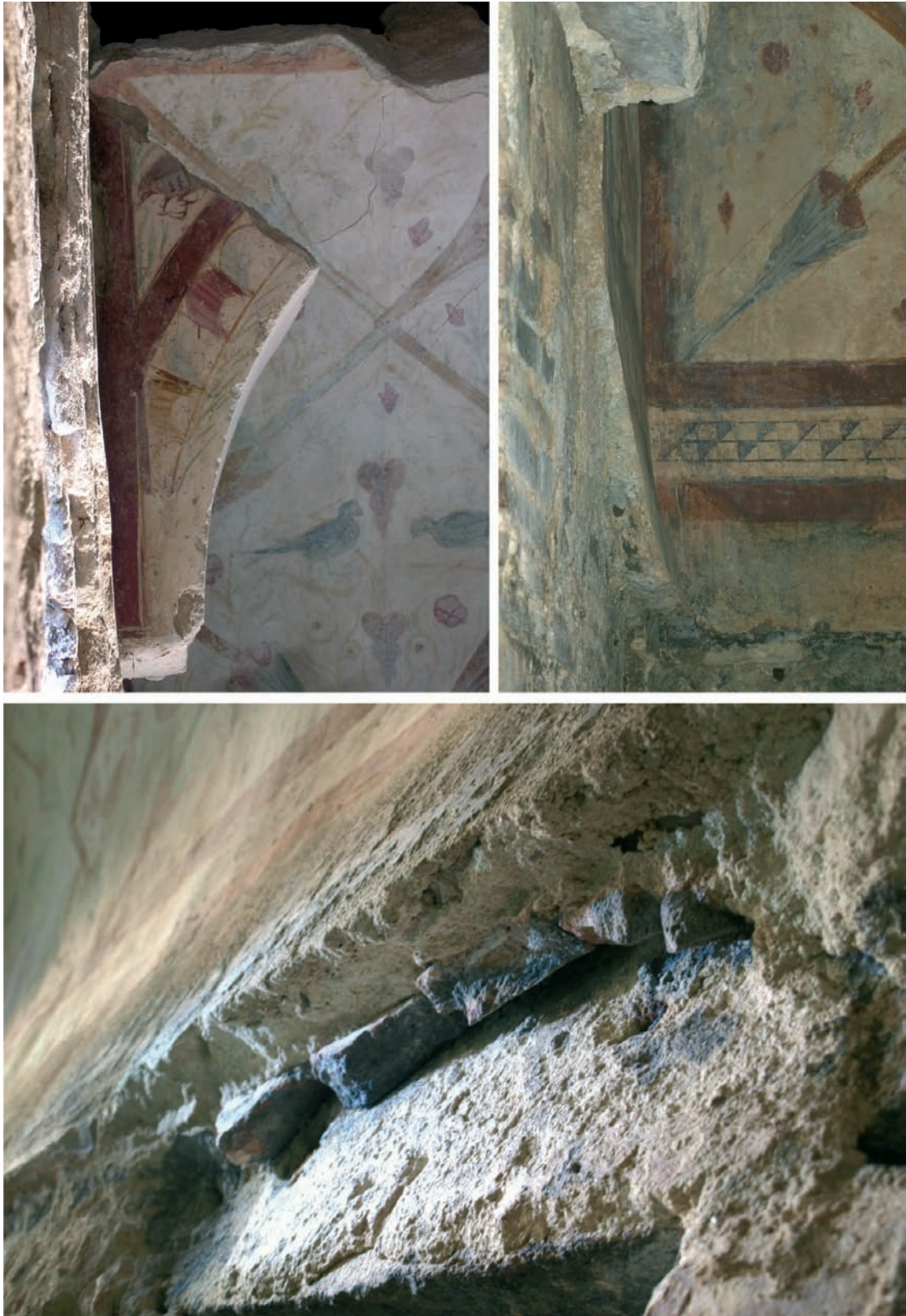
Fig. 17. Distintas fotografías de los revocos que cubren los muros del aula. En la imagen superior izquierda (muro E) se observan las distintas capas de mortero que se aplican. En esta rotura se puede ver una estratigrafía bastante completa de la preparación de las pinturas, en la que se distinguen, al menos, tres capas y el enlucido. En la imagen superior derecha (muro W) se puede apreciar cómo se engrosa el mortero, hasta llevarlo a la altura a la que se localizaría la imposta de mármol, que en esta zona se ha perdido pero permanece su impronta. En la imagen inferior (muro S) se pueden ver los fragmentos de ladrillo dispuestos bajo el mortero sobre el dintel de la hornacina.
