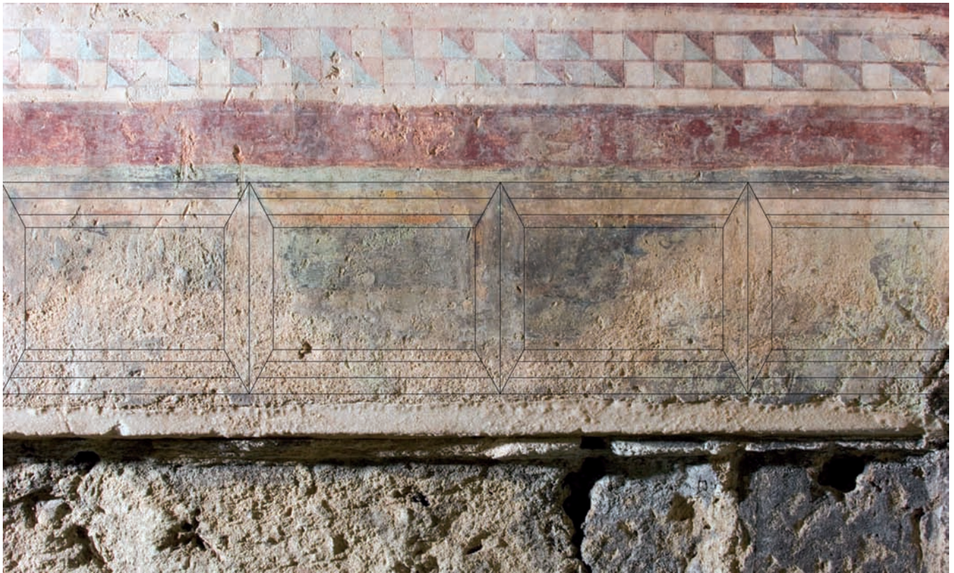
Fig. 35. Hipótesis de la composición ortogonal del arranque de la pintura mural de la bóveda
