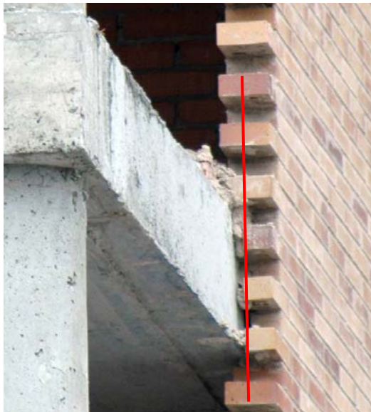
Fig.1: Sistema tradicional de apoyo de la fábrica semivolando sobre el borde del forjado y con plaquetas en su frente. Como se muestra en la foto, habitualmente el exiguo apoyo compromete la estabilidad del muro.
