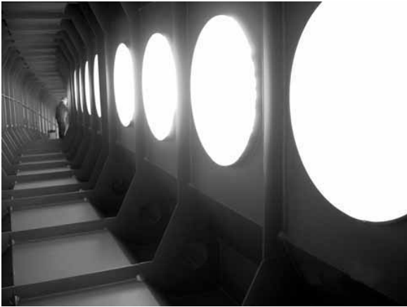
Fig. 19. Trabajos en el interior de los cajones utilizados como corredor de acceso a toda la estructura.
