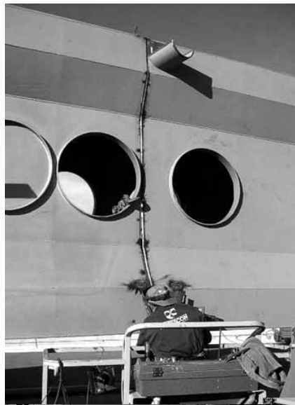
Fig. 34. Holguras en uniones a soportes y entre cajones a completar con pletinas y soldadura.
