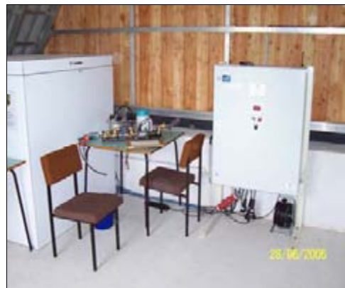
Abb. 10: Fertiger Ausbau der GrWM I mit Winterumhausung (links), Durchflussmesszelle für die Wasserprobenahme (Mitte) und Schaltschrank (rechts)
