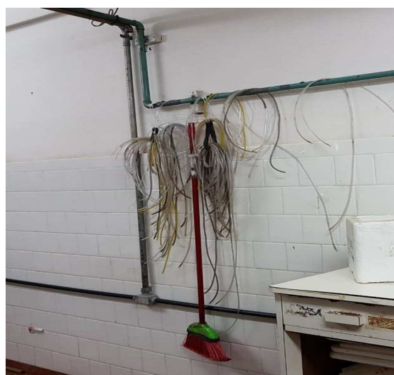
Figura 2 – Não conformidades. Mangueiras desorganizadas, vassoura fora de seu local.
