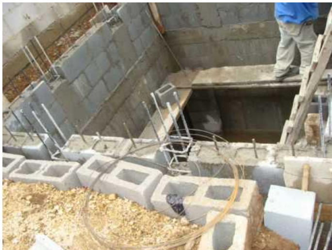
Imagen N° 4.28 Sistemas de Captación de Agua Cisternas de Bloque de Concreto
