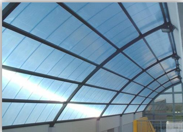
Imagen N° 4.7 Policarbonato en Techos.
