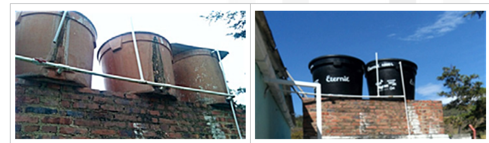
Figura 4.8 Estado inicial de los tanques.
