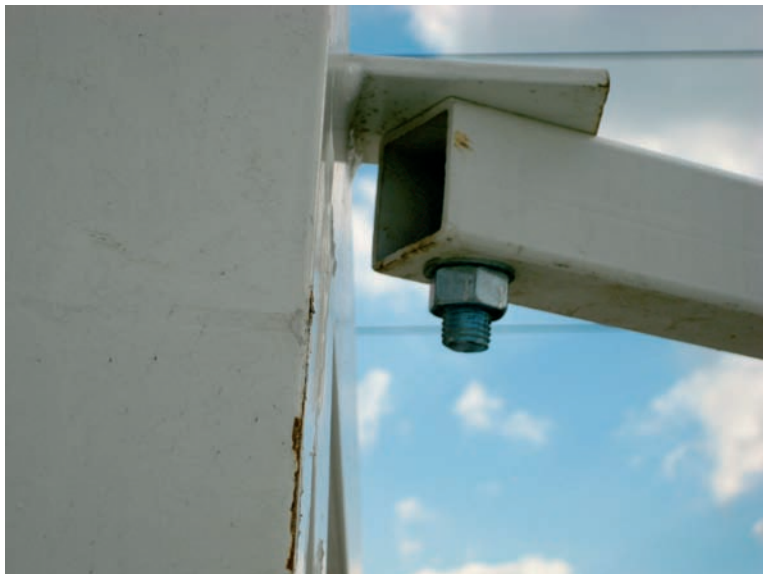
Fot. 10. Brak zamknięcia przekroju rurowego. Photo 10. Steel pipe without anticorrosion protection.
