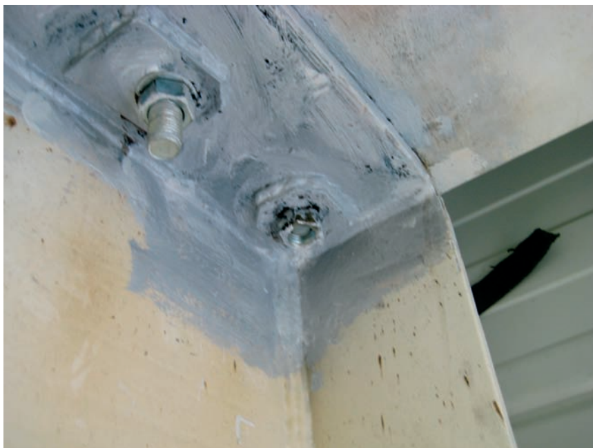
Fot. 1. Przykład zastosowania śrub o nieodpowiedniej długości. Photo 1. The example of incorrect bolts length.
