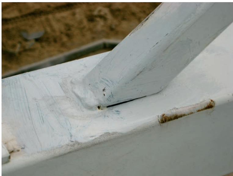
Fot. 8. Niepełna spoina łącząca krzyżulec z pasem kratownicy. Photo 8. The incorrect weld between cross brace and a beam's flange.
