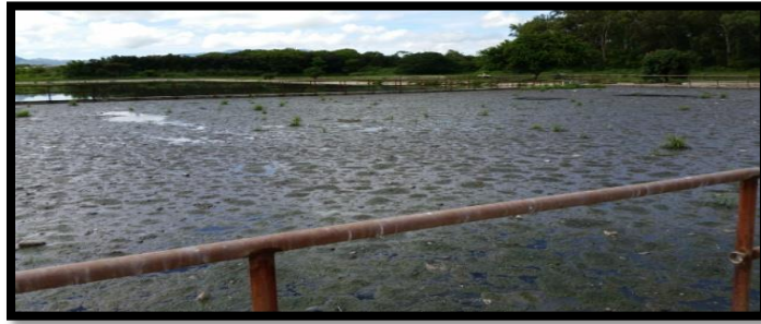
Imagen 3.2: Estado de los reactores UASB
