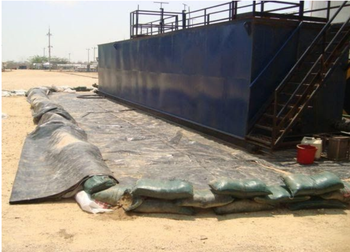
Ilustración 3. Skimmer tank (desnatador) de tratamiento de agua de producción
