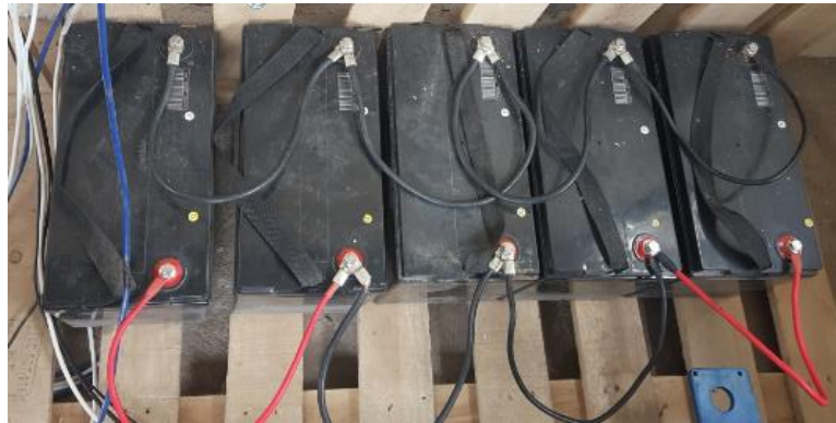
Figura 39. Conexión del Banco de Baterías.
