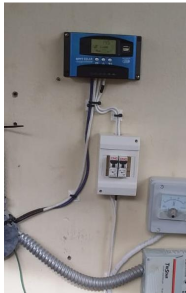
Figura 38. Conexión del Regulador de Carga y el Banco de Paneles Solares.
