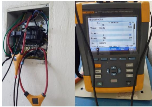
Figura 20. Analizador de carga Fluke 435.
