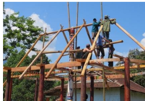
Hình 13. Dựng khung mái (đòn đòn – kèo) Ảnh chụp bởi các thành viên dự án
