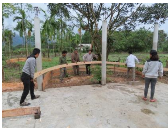
Hình 5. Gia công (uốn) vành hồi ở 2 chái Ảnh chụp bởi các thành viên dự án
