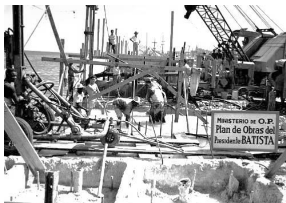
Figura 9. Construcción del tramo final del Malecón de La Habana bajo el Plan de Obras del presidente Batista. (García, R. C., 2014, 20 de noviembre).
