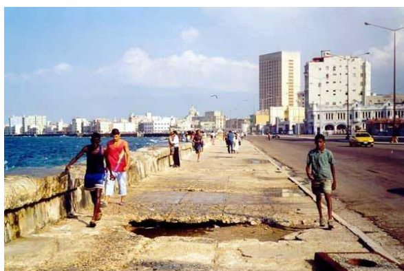
Figura 11. Afectaciones en el Malecón de La Habana. Malecón habanero, sitio de todos los cubanos (Radio Rebelde 2011).
