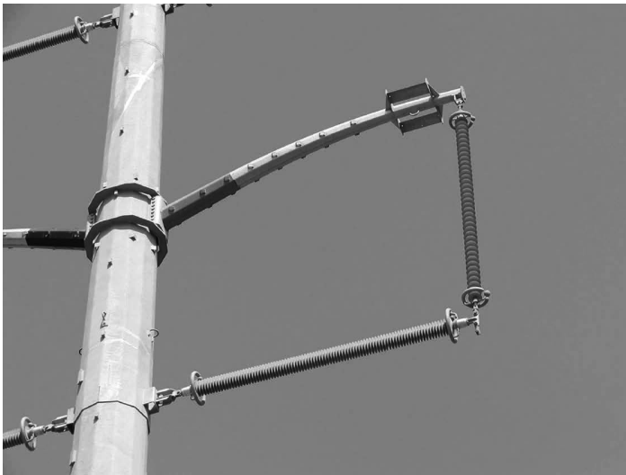
Abb. 4-5 420 kV abgehängter Leitungsstützer
