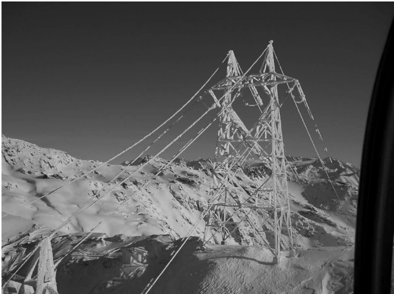
Abb. 5-32 Im Winter durch Eisabwurf gefährdetes Spannfeld einer 420 kV Leitung in den Schweizer Alpen
