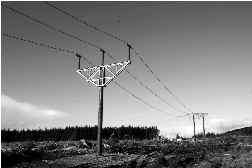
Abb. 3-4 132 kV Leitung mit Trident-Masten in den Highlands von Schottland
