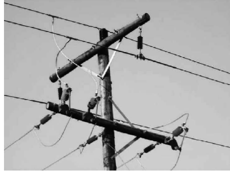
Abb. 2-8 20 kV Isolatoren am Holzmast
