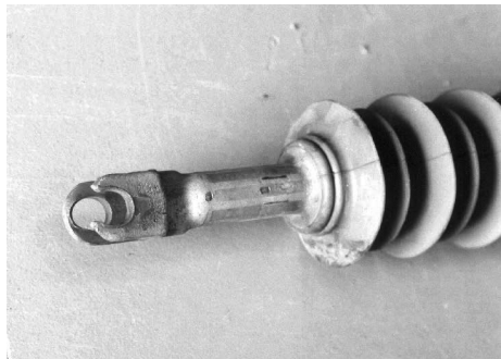
Abb. 5-25 Beschädigte Endarmatur eines PAH
