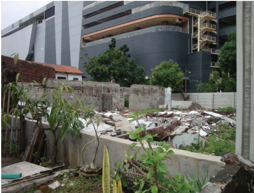
Gambar 7. Beberapa rumah telah di bongkar untuk keperluan parkir (Sumber : Hasil Survey Lapangan)
