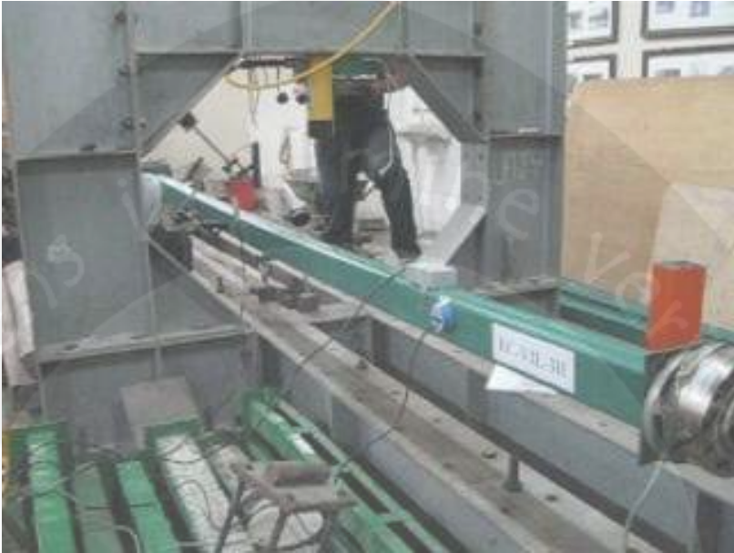
Pengujian Kolom Baja Profil C Gabungan dengan Variasi Jarak Las 3H (KCVJL-3H)
