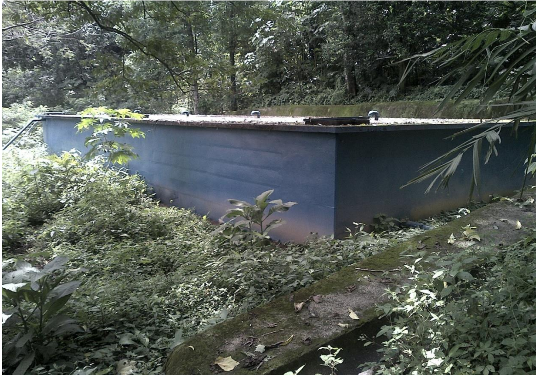
Figura 12. Depósito de agua
