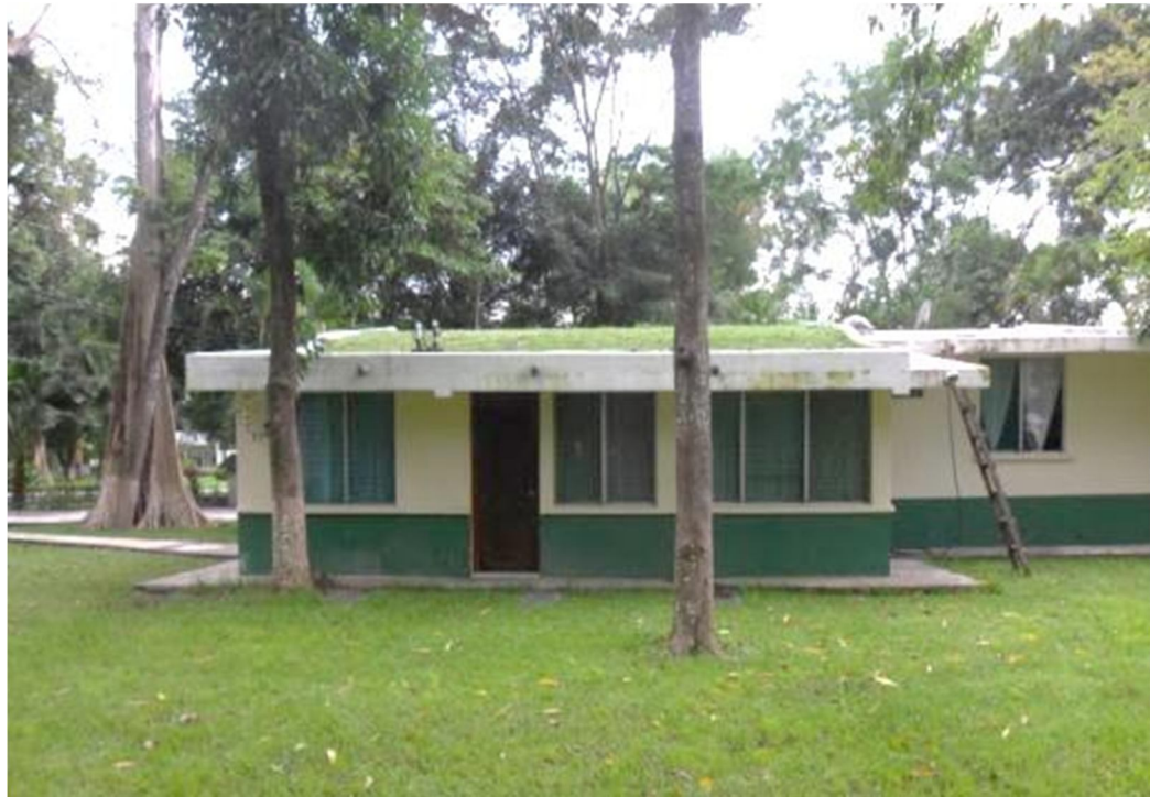
Figura 58. Techo verde tipo extensivo
