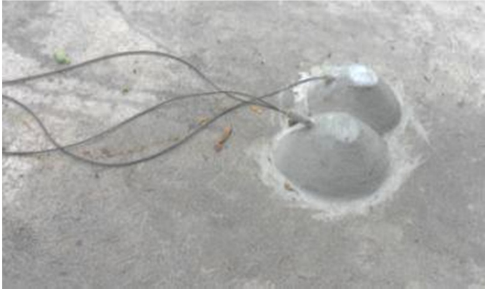
Figura 33. Conexiones que interrumpían en la instalación
