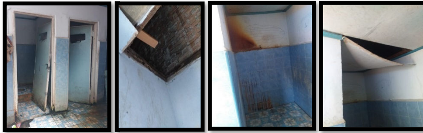
Gambar 2. Kondisi pintu, dinding dan atap sebelum rehabilitasi
