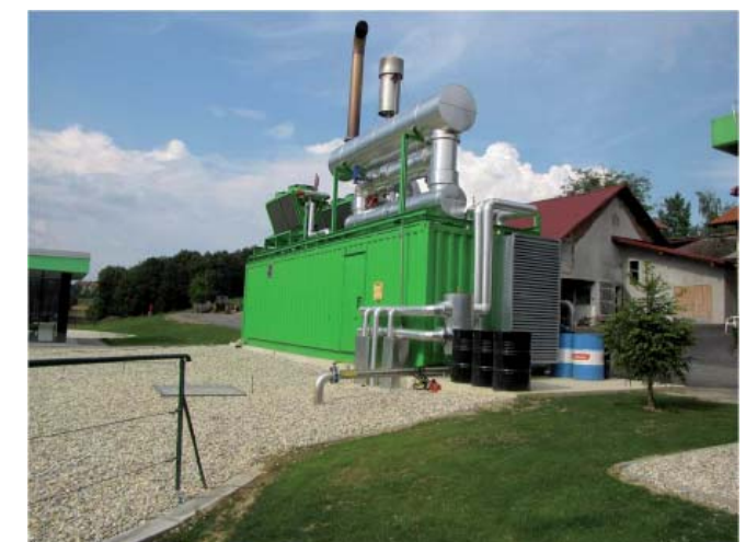
Enota z motorjem MWM je v kontejnerski izvedbi
