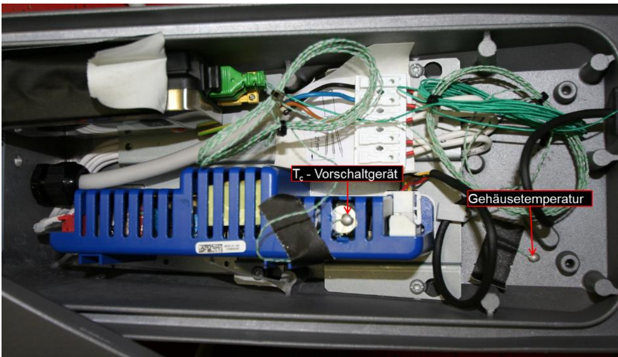
Abbildung 3.16: 3-Kanal Temperatur-Datenlogger montiert in einer der Leuchten
