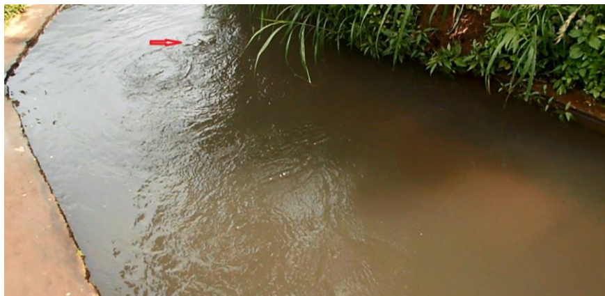
Gambar 3. Letak kebocoran pipa beton (arah panah)
