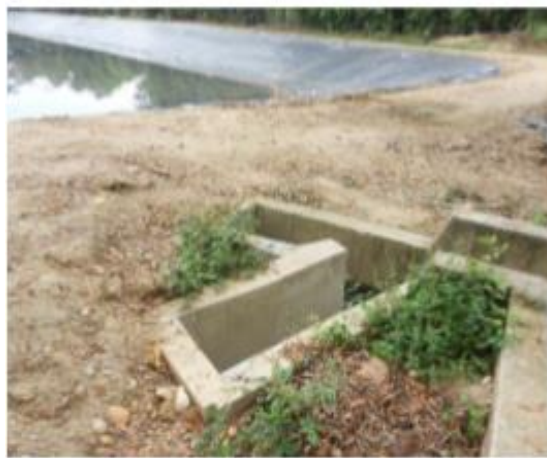
Ilustración 7. Caja de repartición del agua residual
