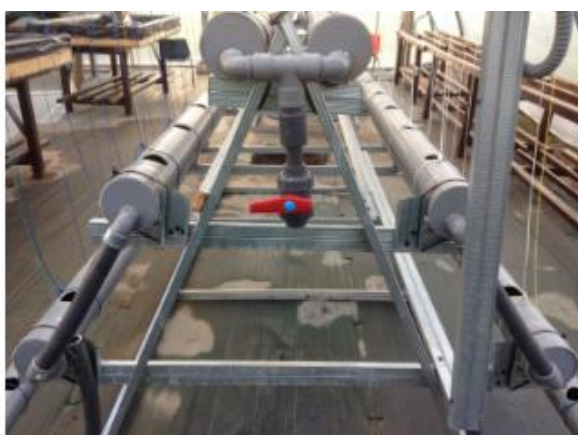
Figura 54: Instalación del sistema NFT
